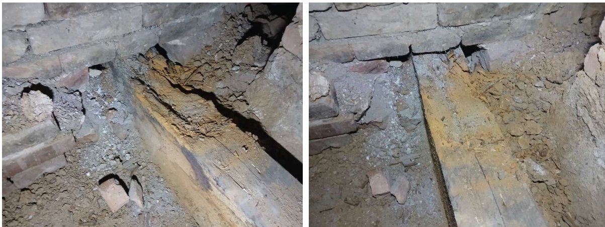
Slika 14. Karakteristično oštećenje oslonačke zone tavanjače na mestima procurivanja kišnice u ispitnom traktu br. 6, kritična tačka 8
