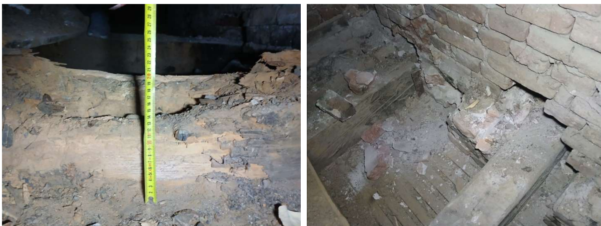
Slika 16. Trulež oslonačke zone tavanjače u ispitnom traktu br. 8, kritična tačka 10 (levo), kritična tačka 9 u ispitnom traktu 9 (desno)
