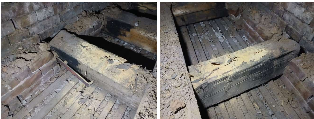
Slika 10. Karakteristično oštećenje oslonačke zone tavanjače u ispitnom traktu br. 7, kritična tačka 5
