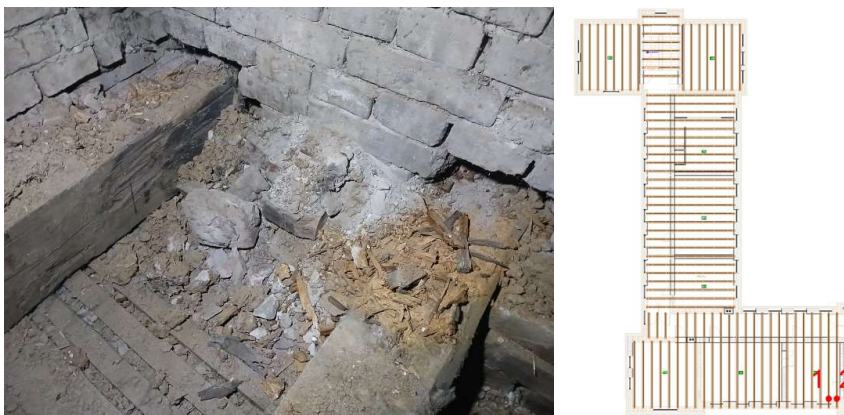
Slika 7. Karakteristično oštećenje oslonačke zone tavanjače na mestima procurivanja kišnice, kritična tavanjača 1 i 2
