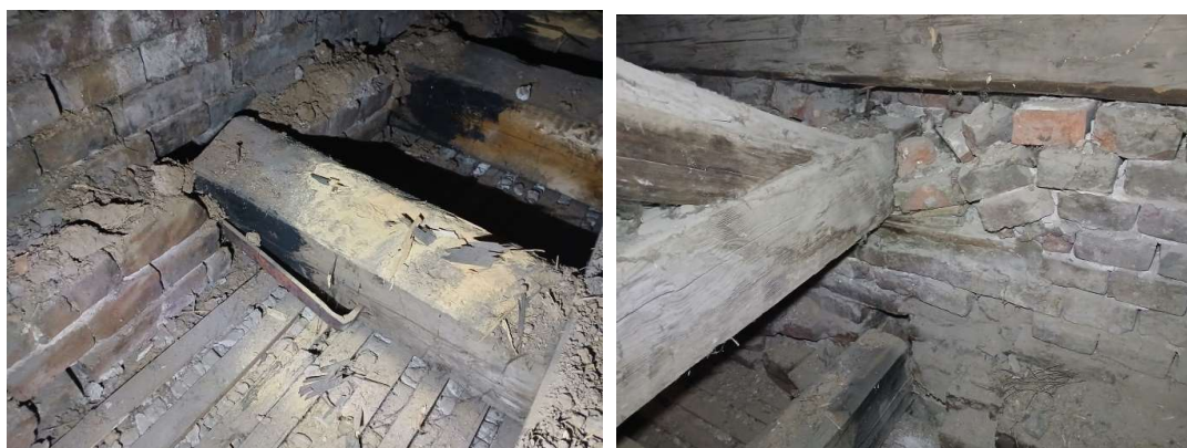
Slika 24. Izostanak sidrenja vrhova klanfi (levo), degradiran slog atike u zoni oslonca krovnog vezača, neophodnost sanacije (desno)
