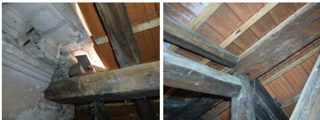
Slika 84. Neadekvatno oslanjanje podrožnjače na zidani nadzidak (levo), neadekvatna veza stuba i slemenjače (desno)
