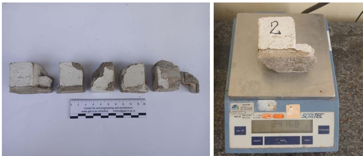
Slika 54. Komadi malterske plastike sa oštećenog venca u osi – J (levo), merenje mase otpalih uzoraka (desno)
