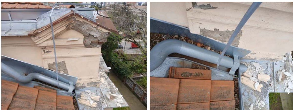
Slika 105. Loš limeni opšiv i posledice kvašenja venca i atikeke u osi 3 (levo), neadekvatan prihvat oluka sa krovne ravni višeg nivoa (desno)
