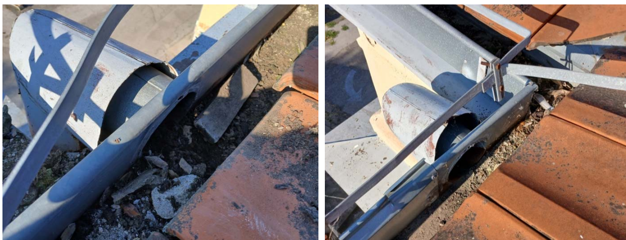
Slika 101. Nepravilno izveden priključak olučne horizontale u osi 10 (levo), redukovanje poprečnog preseka oluka (desno)
