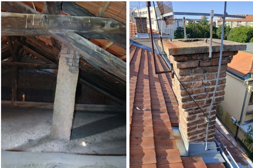
Slika 89. Nakrivljen dimnjak (levo), ispucao dimnjak (desno)
