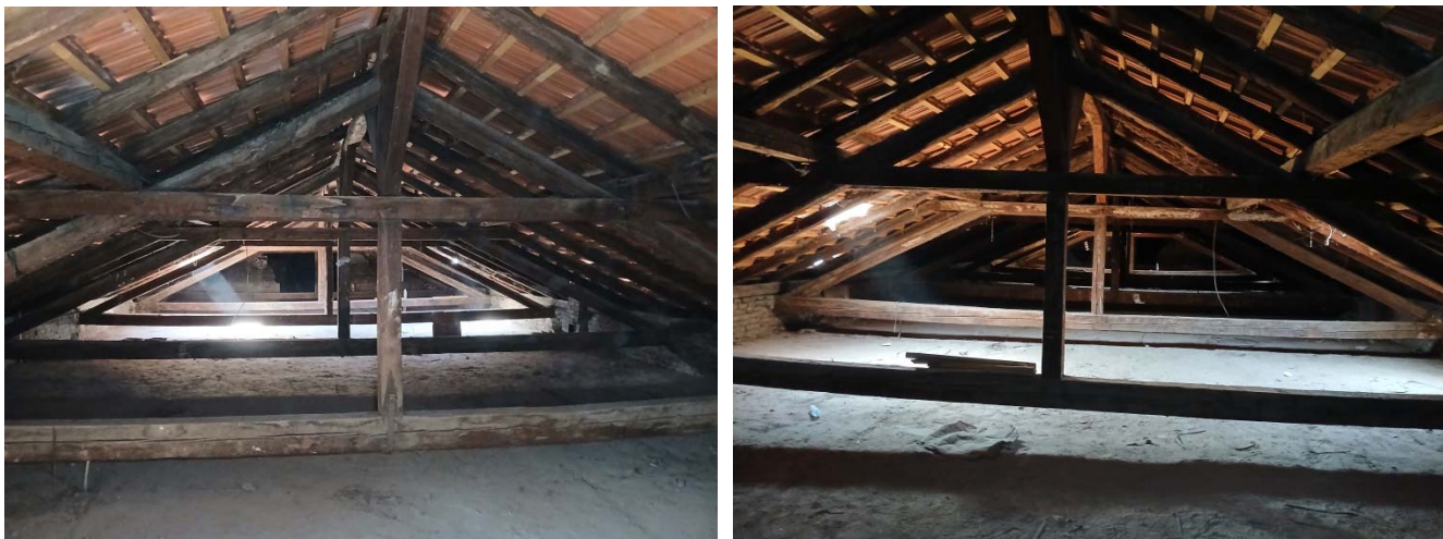
Slika 58. Prekomerne deformacije karakterističnih krovnih vezača TIP 1 levo krilo (levo), vezač TIP 1u desnom krilu objekta (desno)
