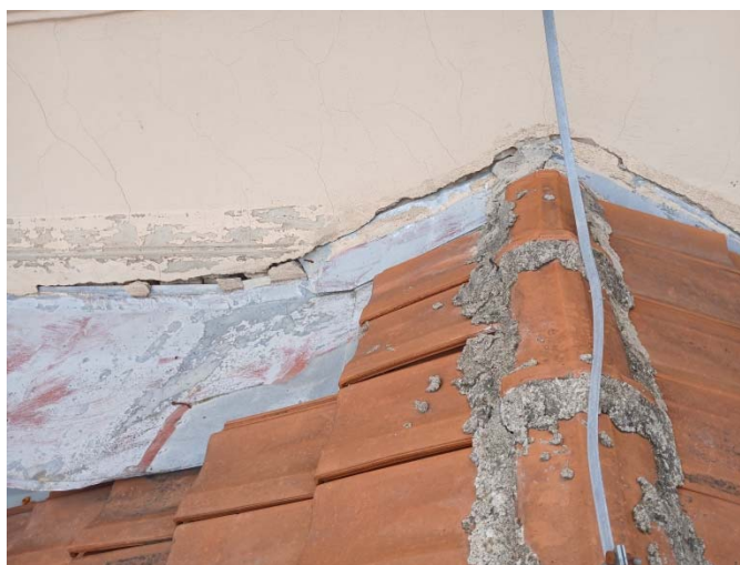
Slika 66. Propagacija ugiba krova na mestu spoja sa kalkanskim zidom kao fiksnom tačkom
