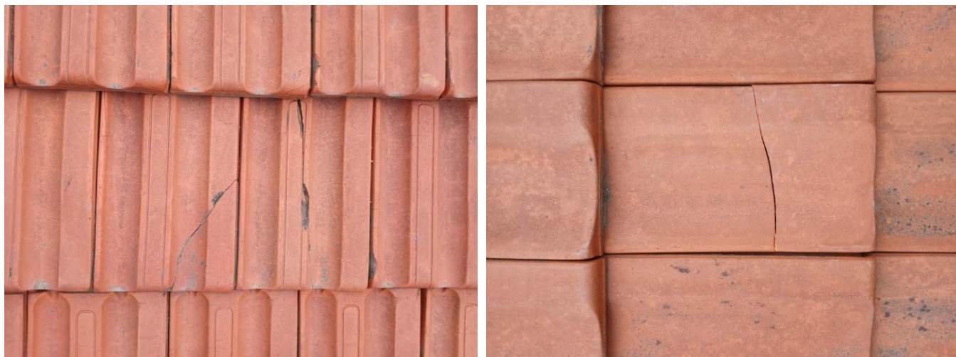
Slika 98. Oštećeni krovni pokrivač
