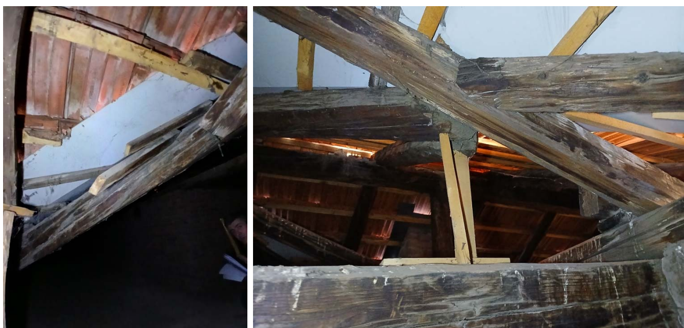
Slika 99. Neadekvatno oslanjanje limenog opšiva u uvali (levo), letvanje olsonaca u uvali (desno)
