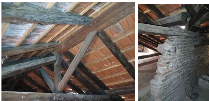
Slika 87. Različita boja građe ukazuje na prethodne radove na rekonstrukciji krova (levo), izostanak oslanjanja podrožnjače na kraju (desno)
