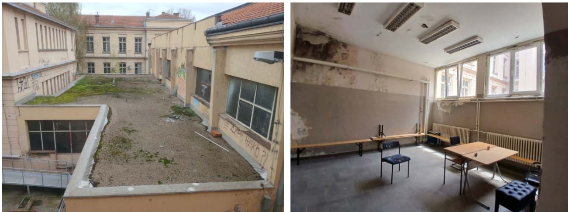
Slika 56. Ravan krov na delu aneksa ka fiskulturnoj sali (levo), procurivanje vode na mestu prodora slivnika kroz atiku i spoja sa olučnom vertikalom (desno)
