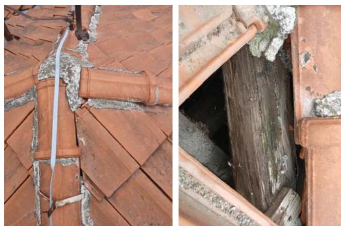
Slika 97. Raznizani krovni poklopci „žljebnjaci“ na delu grebena između osa B-C / 2-3(levo), otpao žljebnjak na grebenu (desno)
