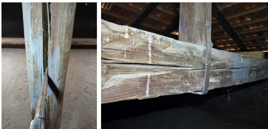
Slika 80. Karakteristična podužna pukotina u stubu (levo), u zategi (desno)
