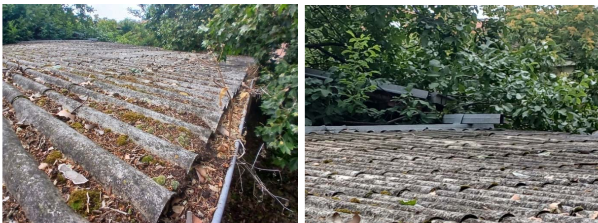
Slika 113. Zapunjena olučna horizontala (levo), kišni odvod sa stambenog objekta na susednoj parceli sproveden na krov iznad kabineta za hemiju (desno)
