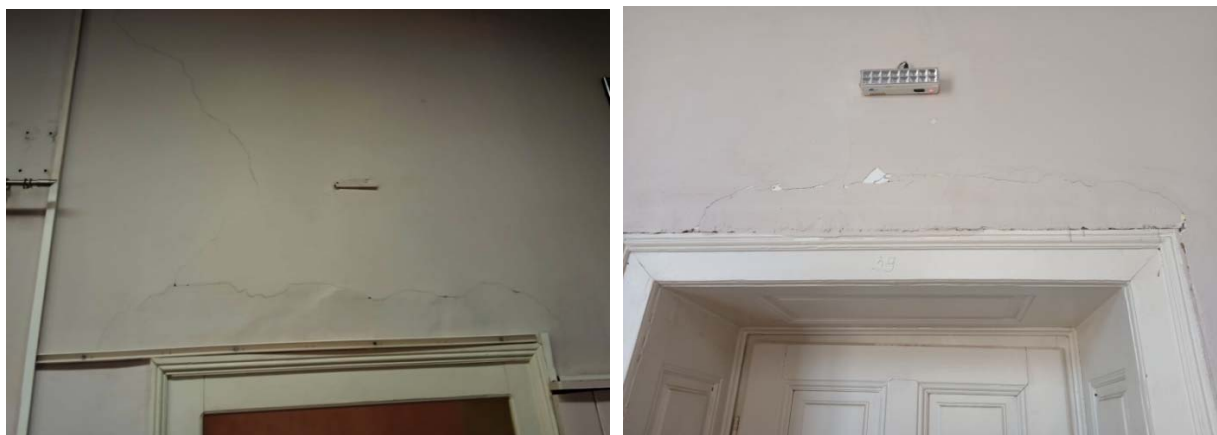
Slika 45. Karakteristične prsline ispod plitkih nadvratnih lukova i lukova
