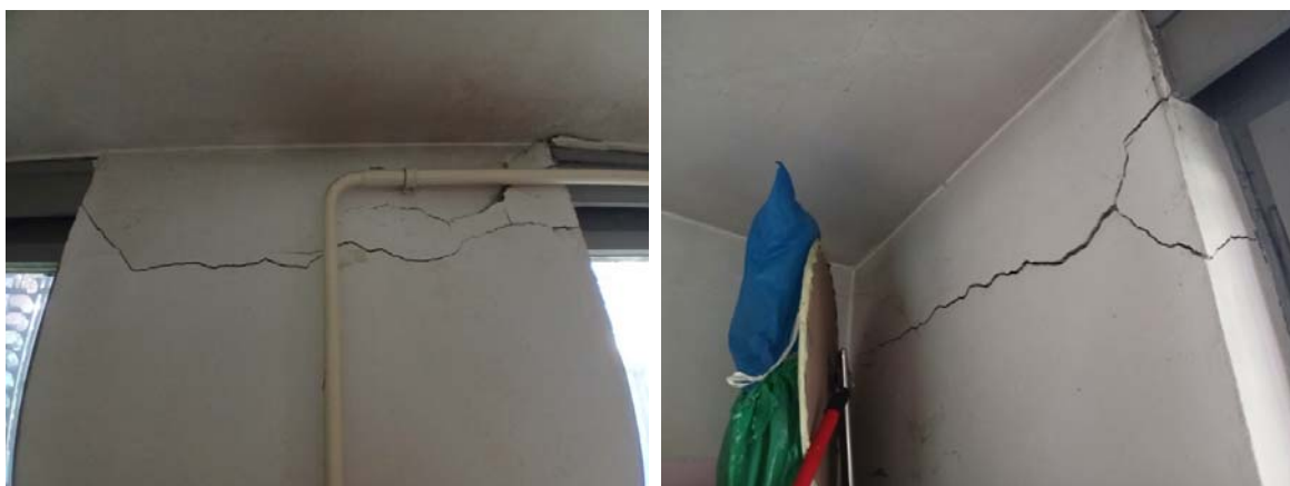
Slika 108. Pukotine na fasadnim zidovima laboratorije za hemiju
