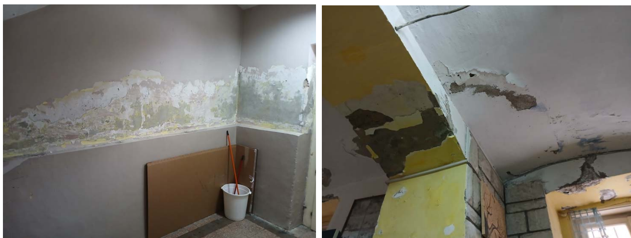
Slika 50. Tragovi vlage na podrumskim zidovima (levo), kapilarno penjanje vlage uz soklene zidove – unutrašnja strana (desno)
