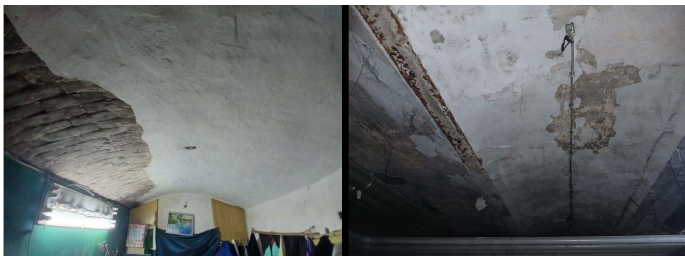
Slika 33. Stanje svodova na tavanicama suterenske etaže u tehničkoj prostoriji (levo), podstanici (desno)
