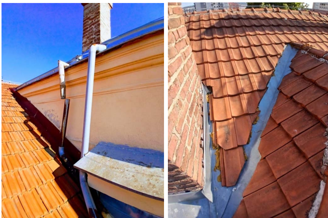
Slika 104. Izvučena-prekinuta olučna vertikalna E (levo), neadekvatno ukrojen crep u uvali (desno)
