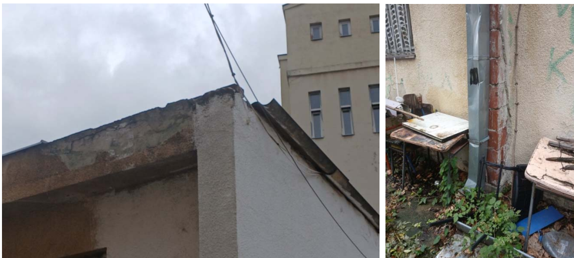
Slika 112. Oštećen opšiv i smaknute salonit table (levo), izlivanje kišne kanalizacije neposrednos uz sokleni zid aneksa (desno)
