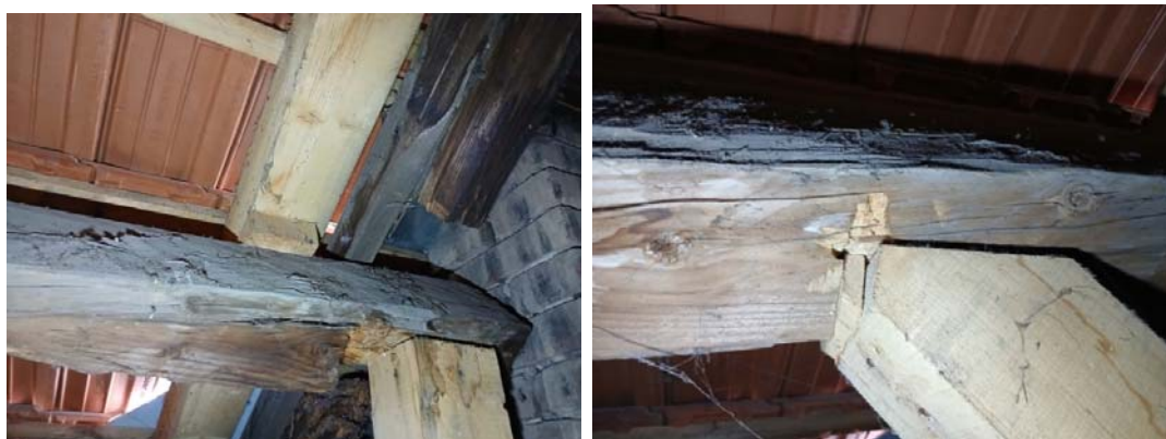
Slika 88. Neadekvatno izvedene veze prilikom poslednje sanacije krovne konstrukcije
