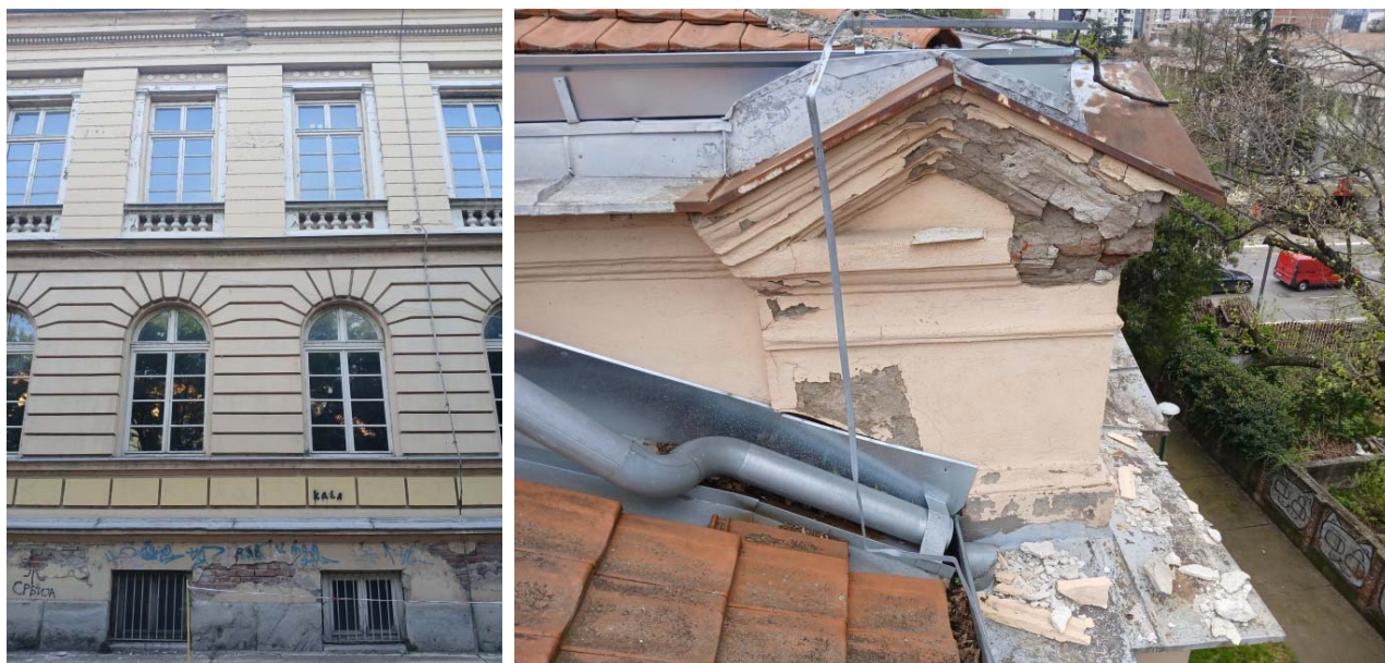
Slika 55. Prostor pod merom zabrane prolaza usled opasnosti od pada fasade osa – J (levo), otpadanje dekorativnog maltera sa venca zapadne fasade osa - B (desno)
