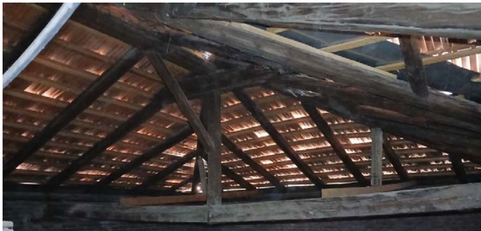
Slika 91. Loše uklopljen krovni pokrivač
