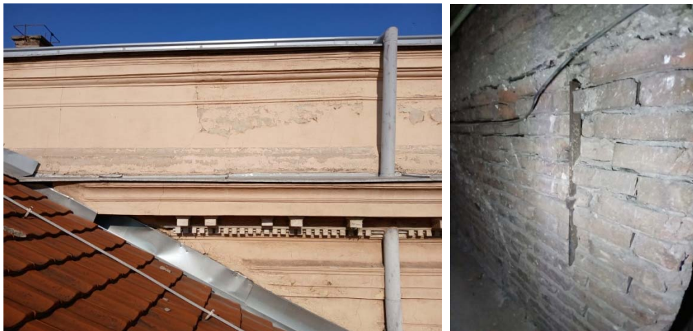
Slika 49. Dalja propagacija prslina iznad krovnih ravni na zid atike u osi E (levo), kotva metalne zatege u kalkanskom zidu u osi E (desno)
