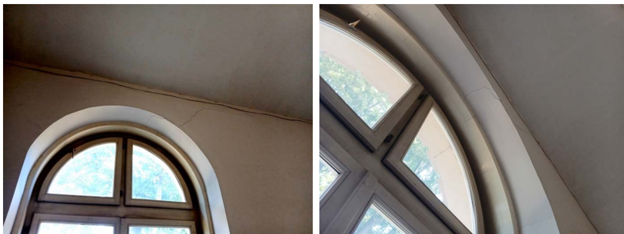
Slika 46. Karakteristične prsline na lukovima iznad fasadnih otvora prizemlja u osi B
