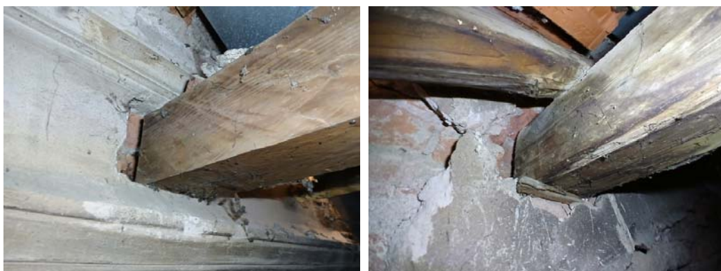
Slika 83. Neadekvatno oslanjanje podrožnjača na zidane nadzidke
