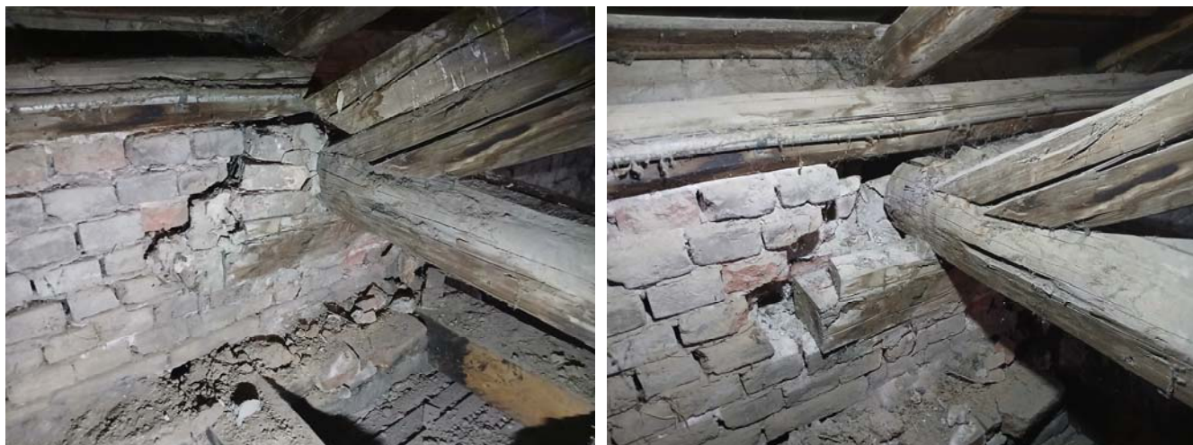
Slika 7. Stanje oslonca glavnog vezača krova u istočnom krilu (levo), stanje nakon otvarnja oslonca (desno)
