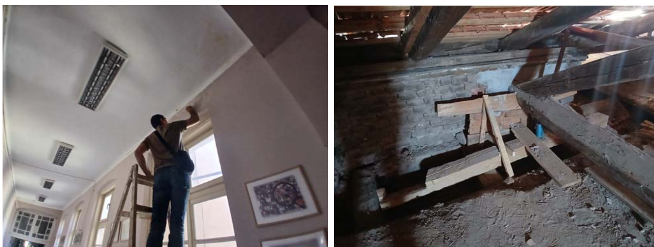
Slika 6. Pojava vlage na spoju tavanice i zida u osi 4 istočnog krila (levo), sanacija oslonačkog jastuka krovnog vezača iznad mesta procurivanja (desno)
