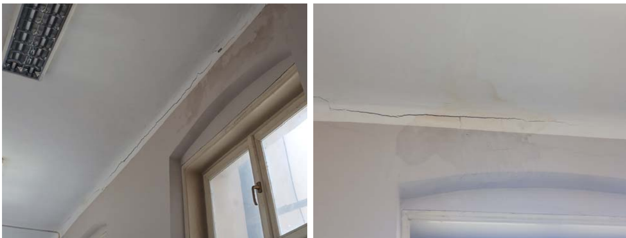
Slika 5. Novonastale pukotine na spoju plafonske konstrukcije i fasadnih zidova u osama H i 4
